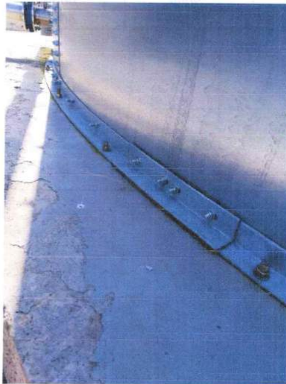
Fig. 2 Fixarea rezervorului de fundație cu suporturi de ancoraj și ancore din oțel M16
